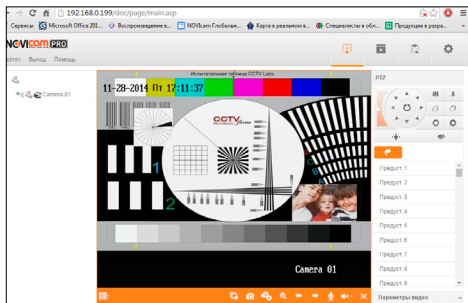
Рис.29 Просмотр IP камеры.
